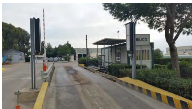
Figura n. 4: Portale Radiometrico installato all’ingresso dell’impianto.
