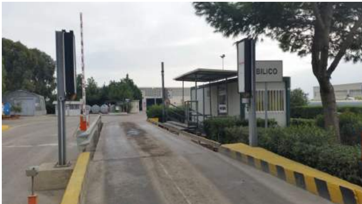
Figura n. 4: Portale Radiometrico installato all'ingresso dell'impianto.
