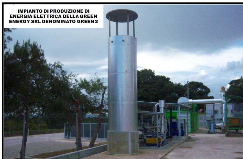
Figura n. 3: Vista frontale dell'Impianto di produzione di energia elettrica della Green Energy srl denominato GREEN 2, contrada "Console" - Massafra (TA).
