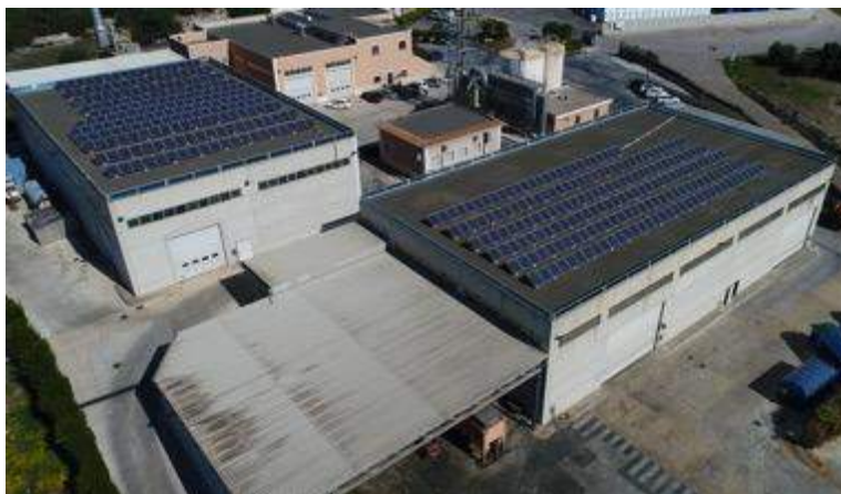
Figura n. 17: Impianto fotovoltaico sito in Massafra alla contrada Forcellara San Sergio.
