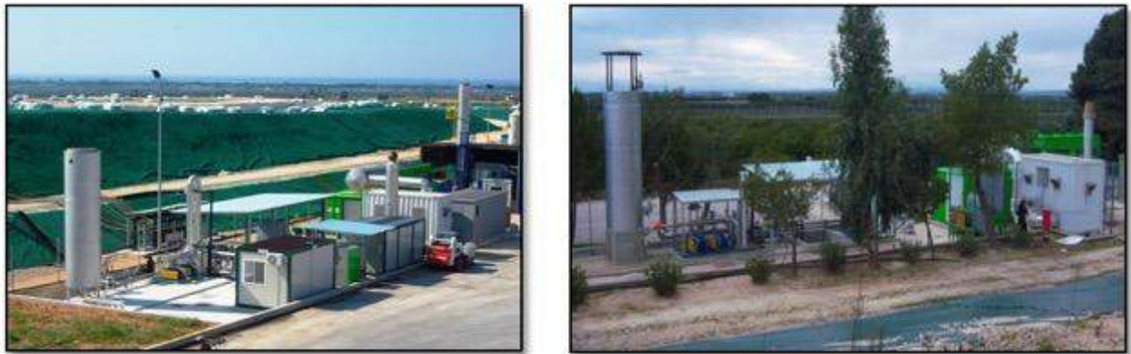
Figura n.6: Impianti di produzione di energia elettrica della GREEN ENERGY Srl, GREEN 1 e GREEN 2
