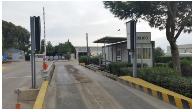
Figura n. 4: Portale Radiometrico installato all'ingresso dell'impianto.
